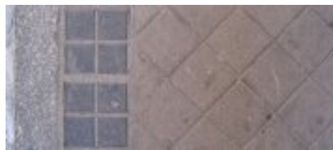
Imagen 20 : Textura adecuada para las aceras
